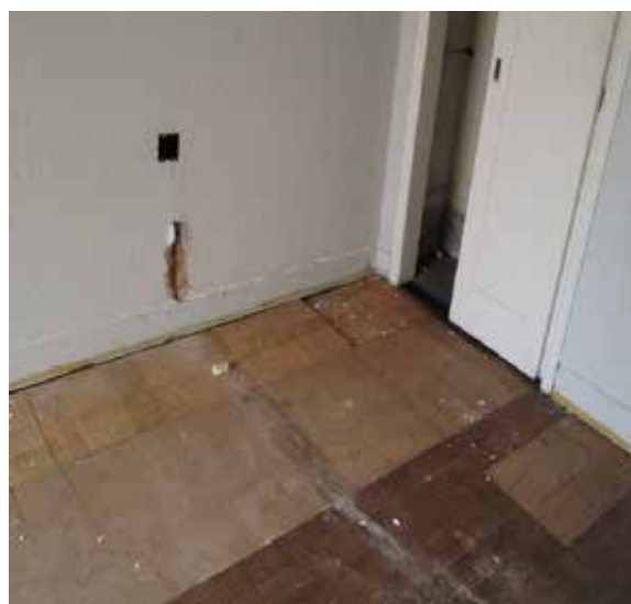
Dormitório – armário embutido; assoalho de madeira em mau estado de conservação.
