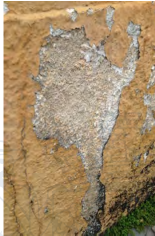
Figura 13 – Desplacamento de tintada torre da CICA Fonte: Acervo do Autor, 2015.
