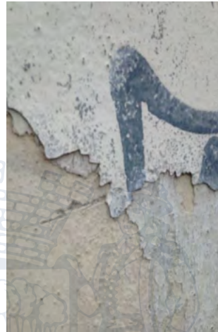
Figura 14 – Desplacamento e pixações na torre da CICA Fonte: Acervo do Autor, 2015.
