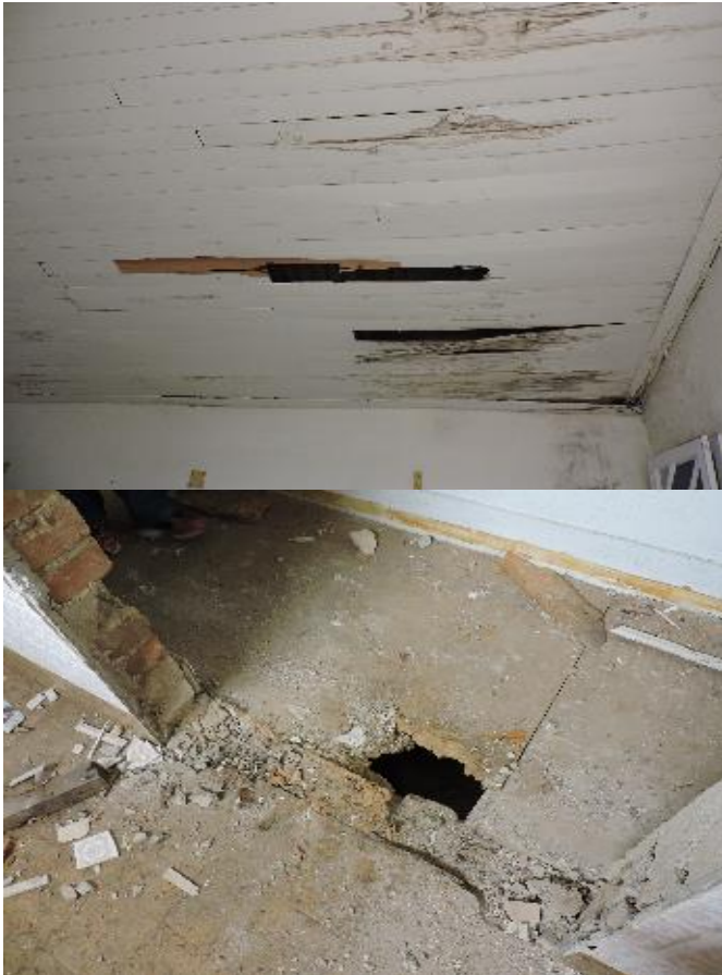
Figura 4: Imagens do forro e do assoalho em péssimo estado de conservação. Fonte: Própria, 2016.
